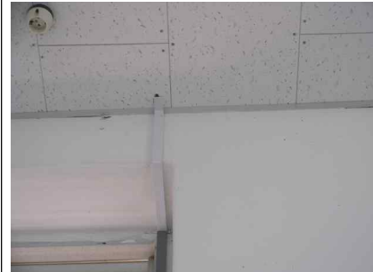
<전기실 내부 벽체 균열>
