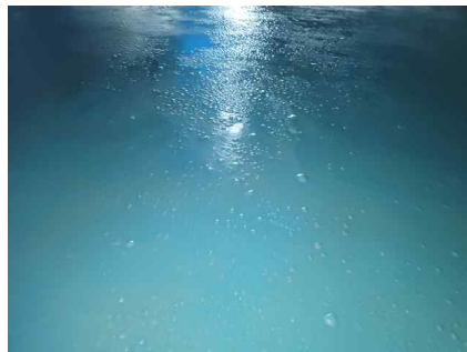
<배수지 1지 바닥슬래브 도장기포>
