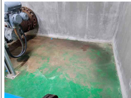
<유입밸브실 바닥슬래브 체수흔적>
