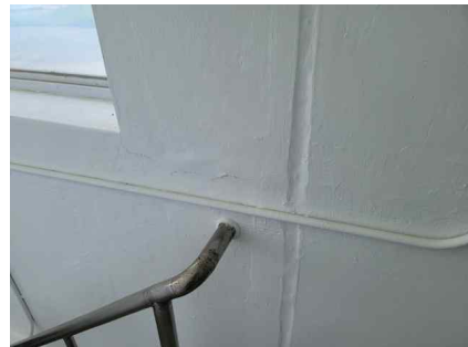
<검수실 내부 벽체 균열>
