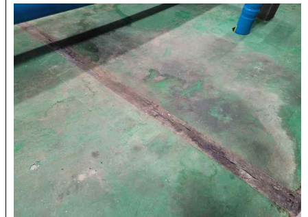
<유입밸브실 바닥슬래브 실링재 열화>
