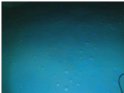
<배수지 1지 바닥슬래브 도장기포>
