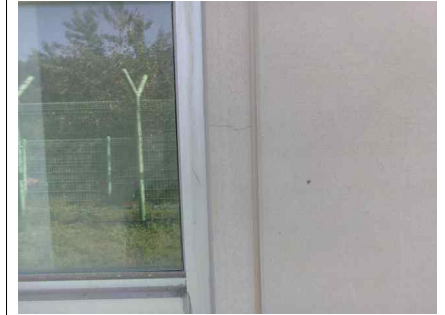
<전기실 외부 벽체 균열>
