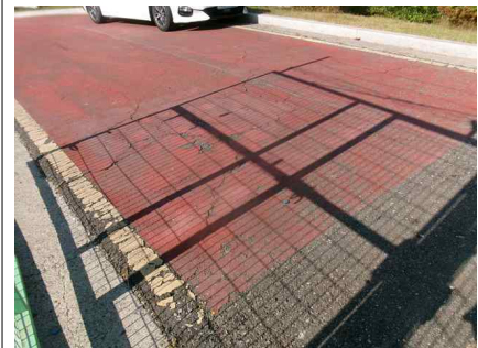
<진입로 포장부 망상균열>
