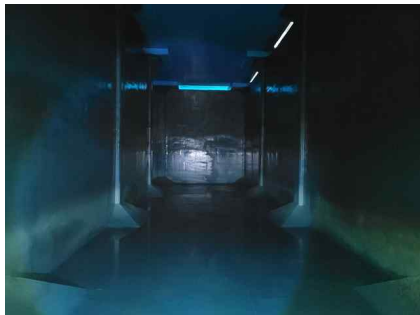
<배수지 1지 전경>
