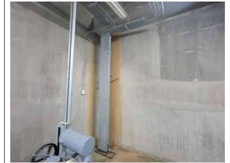
<유입밸브실 벽체 누수흔적>
